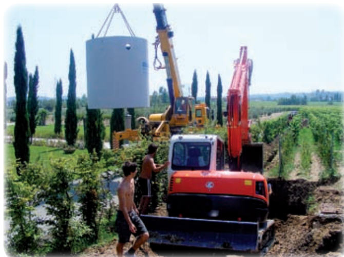
Figura 4 - La posa in opera della vasca di sedimentazione e della vasca SBR.
